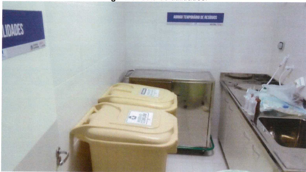
Figura 5: Sala de utilidades.
